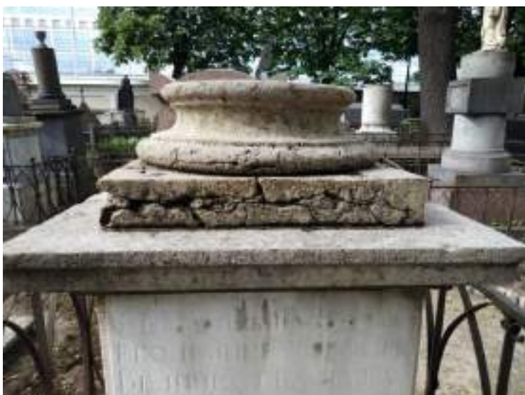
Илл. 18. Фрагмент памятника А.А. Горяйнову. Плинт под базой колонны. После удаления поверхностных загрязнений и удаления старого мастиковочного материала
