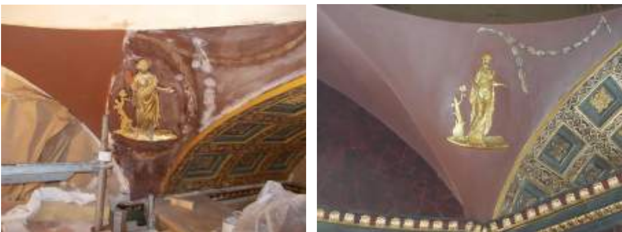
Илл. 38-39. Консервации и реставрации штукатурного слоя фона, лепного декора с позолотой и окраской фона с сохранением girlyandy, выявленной после удаления поздних слоёв краски на северо-западном парусе свода купола. 2011-2012 годы
