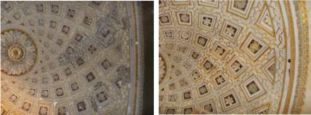
Илл. 34-35. Фрагмент центрального плафона купольной части яшмового кабинета до и после консервации реставрации. 2009-2012 годы
